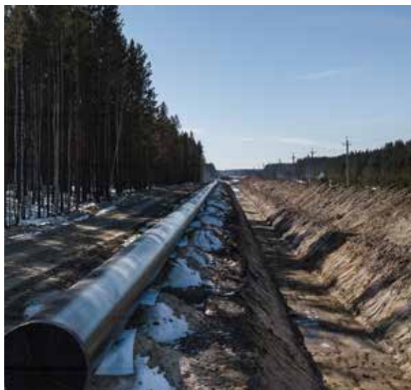
Магистральный нефтепровод «Красноленинская–Шаим–Конда» с 26 км по 68 км (ХМАО, Югра) Источник: Транснефть
