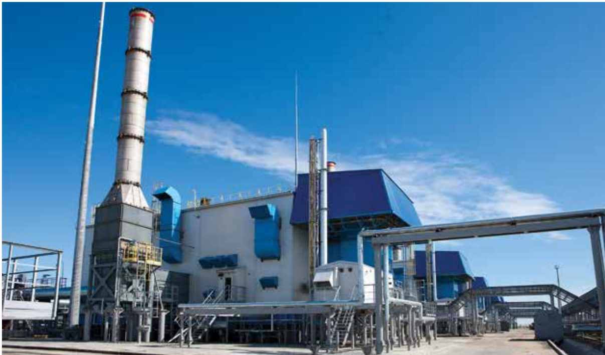
Компрессорная станция «Байдарацкая»
