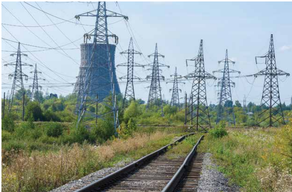
ЛЭП вдоль железной дороги
