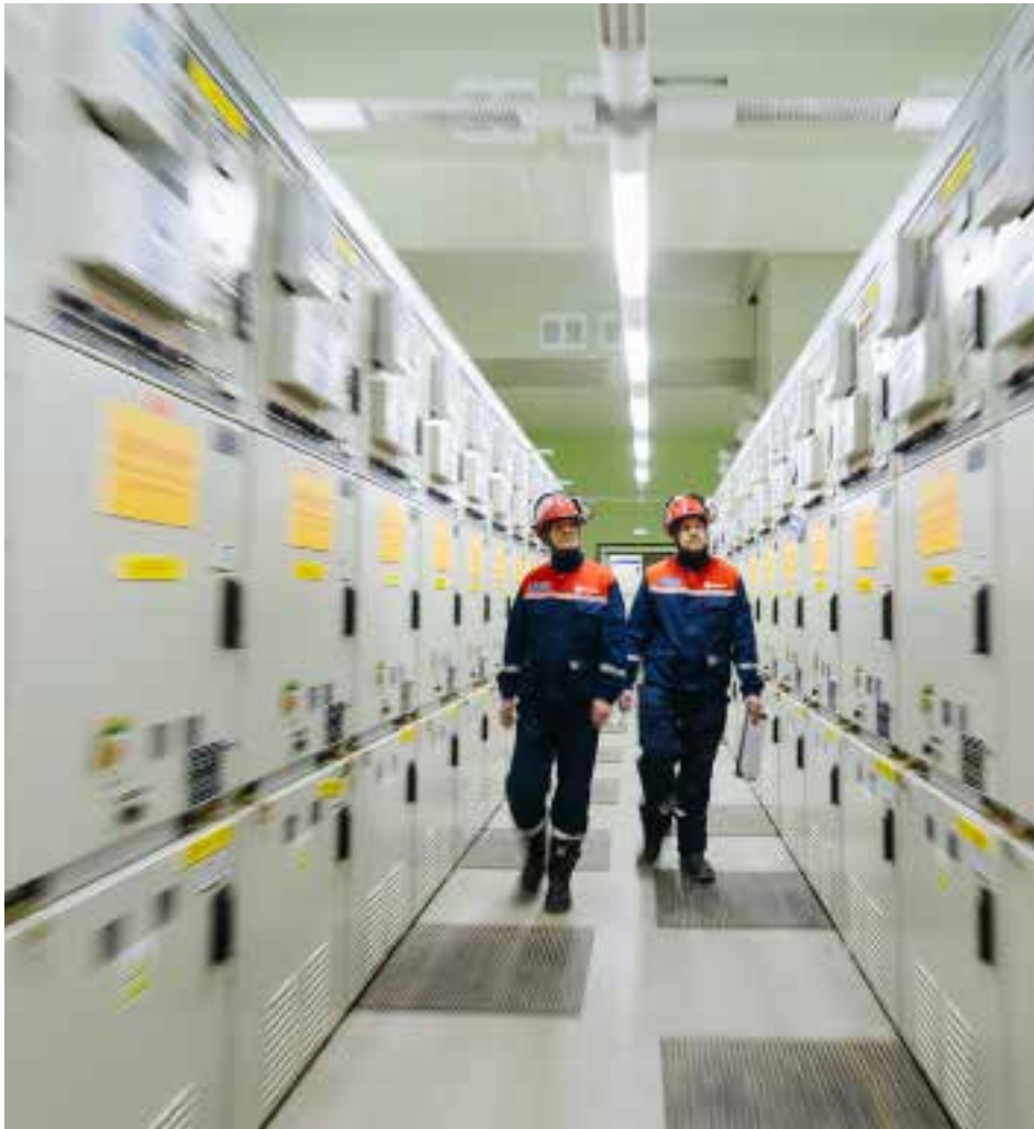
Серверная Источник: «МРСК Северо-Запада»
