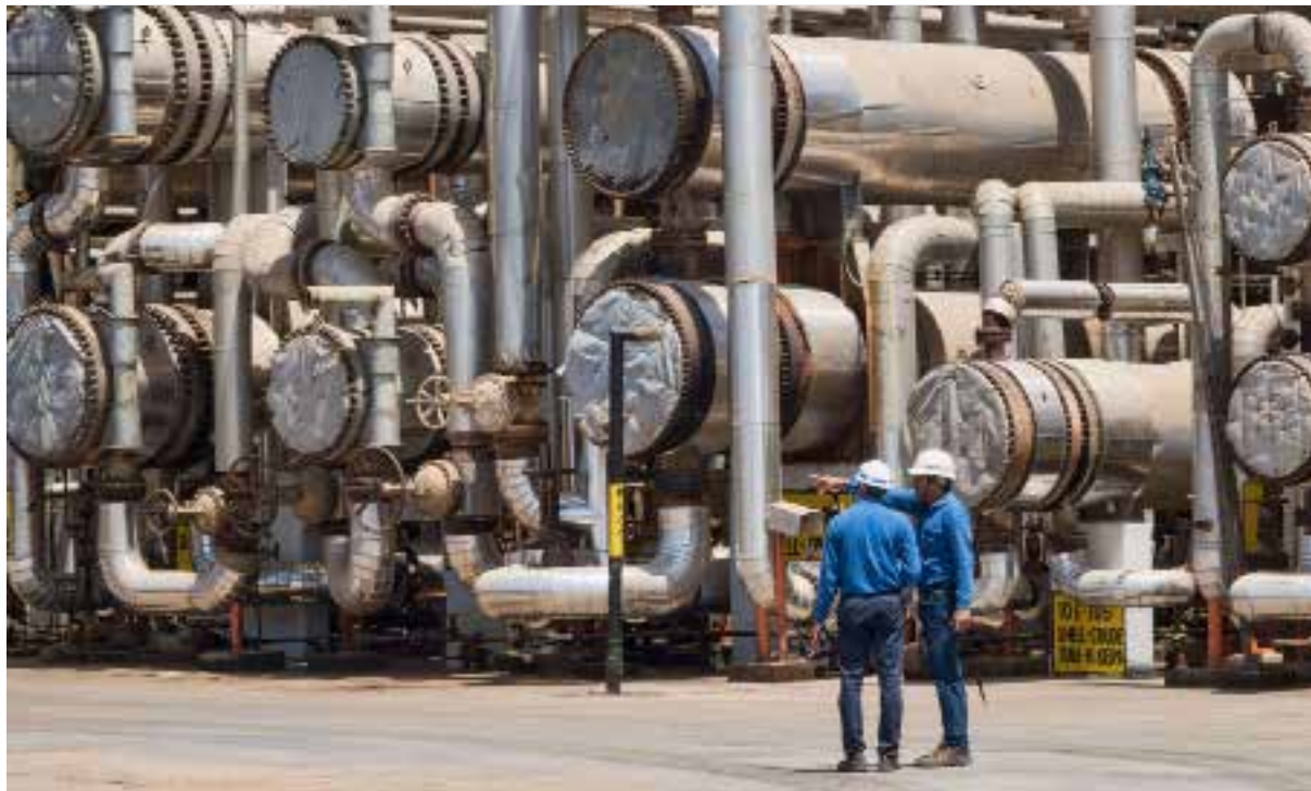
Нефтеперерабатывающий комплекс Nayara Energy, Индия
