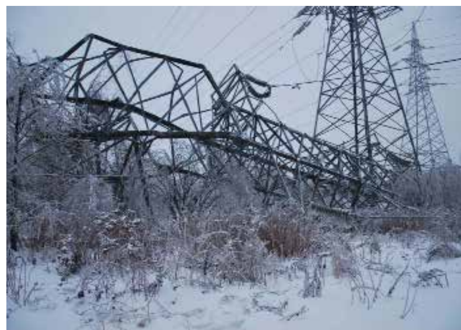
Повреждение ЛЭП Источник: samelectrik.ru
