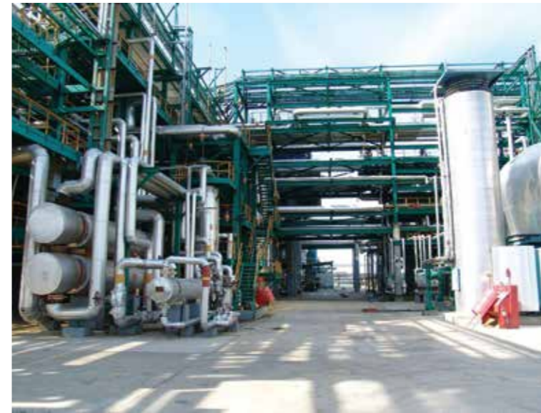
Установка по производству водорода Источник: «Славнефть-ЯНОС»
