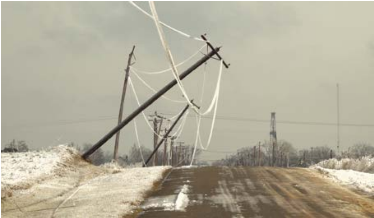
Авария на ЛЭП из-за обледенения проводов
