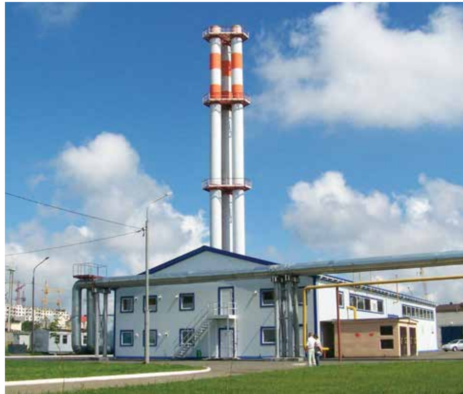
Городская котельная Источник: asninfo.ru
