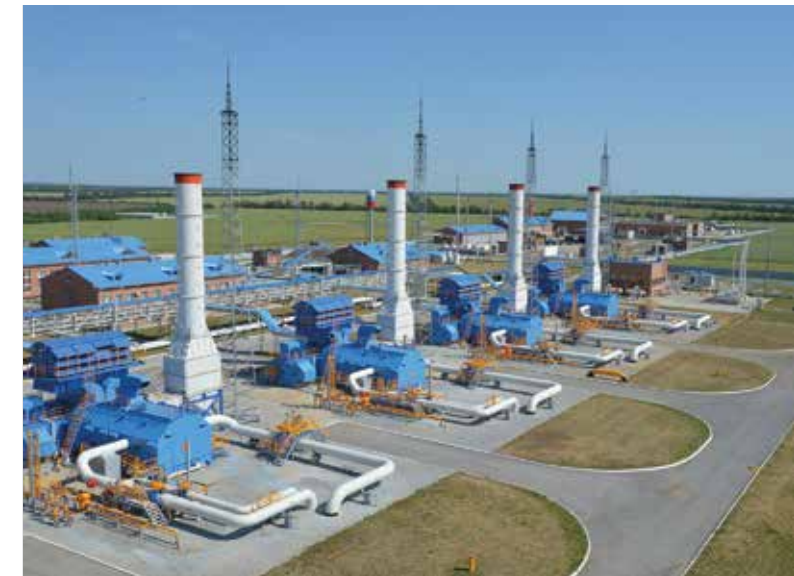
Компрессорная станция Сальская Источник: «Газпром»
