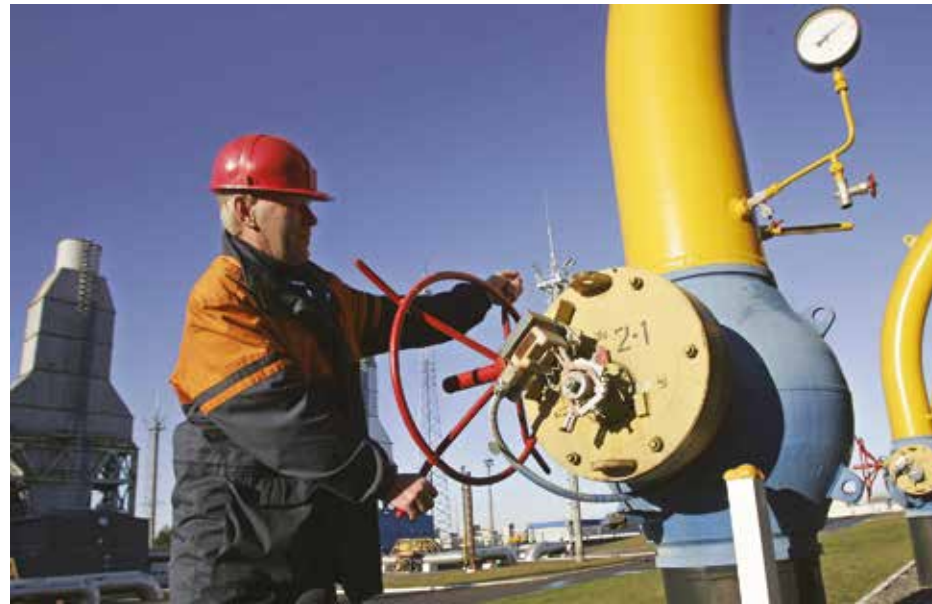
Газопровод «Ямал – Европа»
