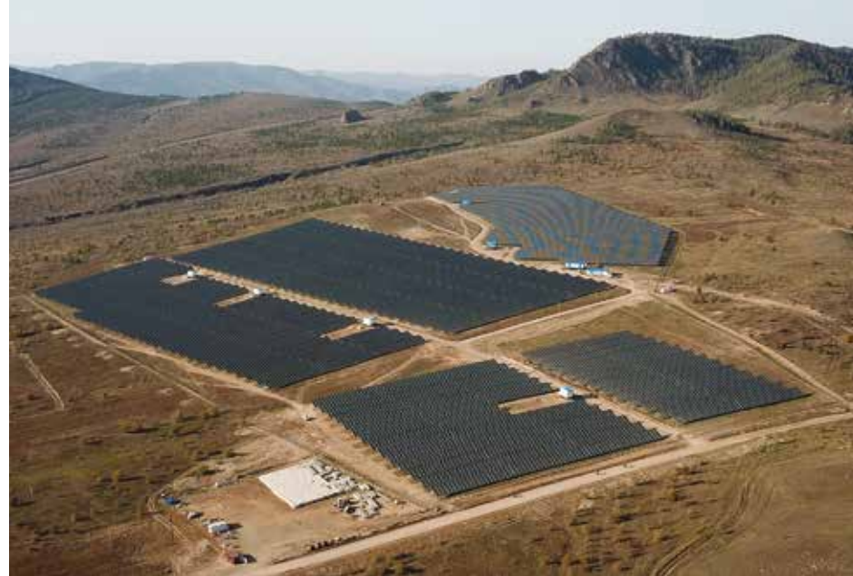
Тарбагатайская СЭС Источник: vershina.energy
