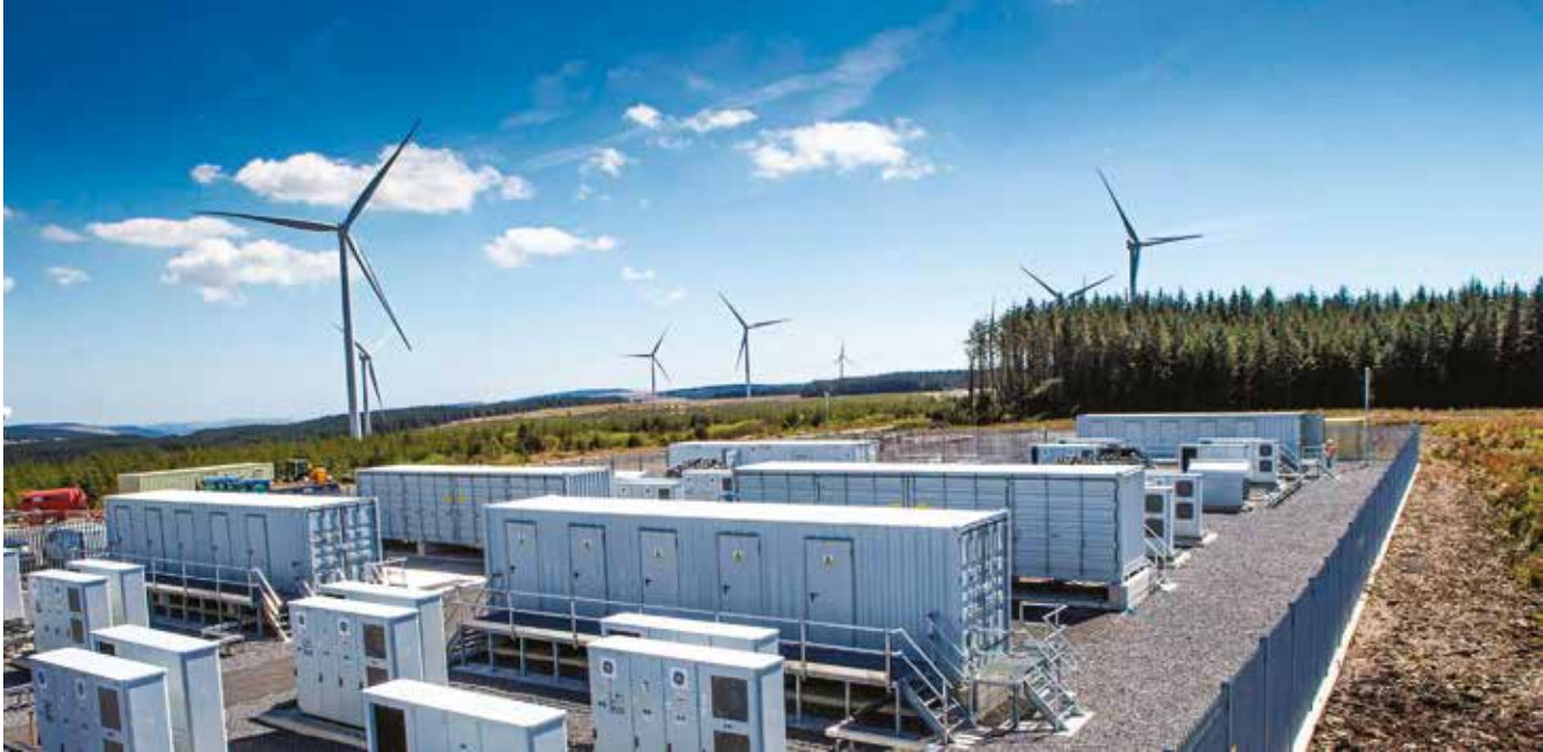
Системы накопления энергии
