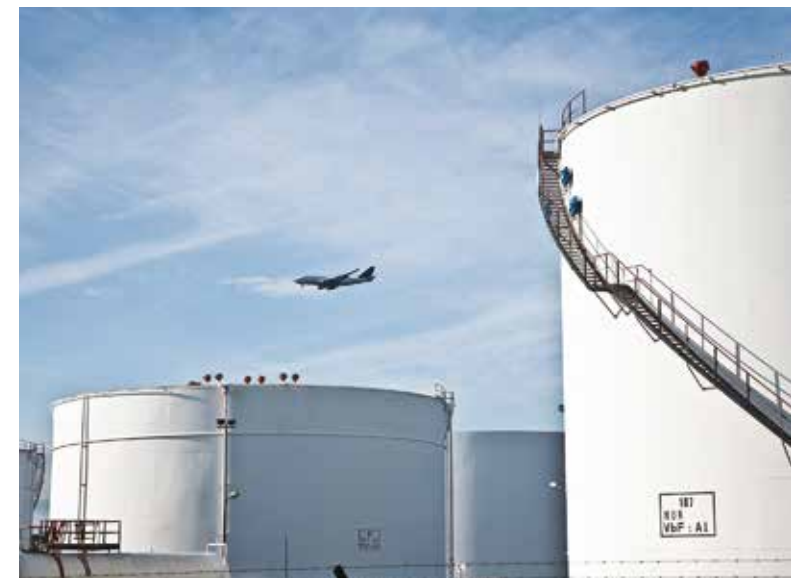
Резервуары с нефтью
