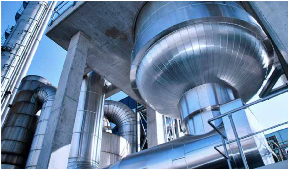
Установка по производству водорода
