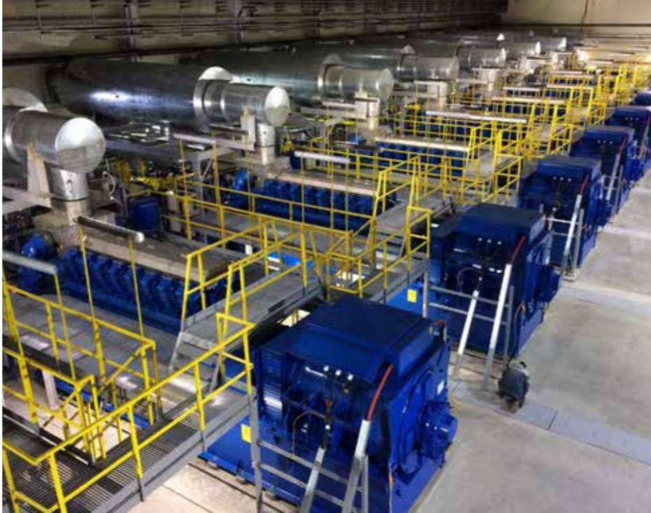
Газопоршневая электростанция Источник: «Ролт Инжиниринг»
