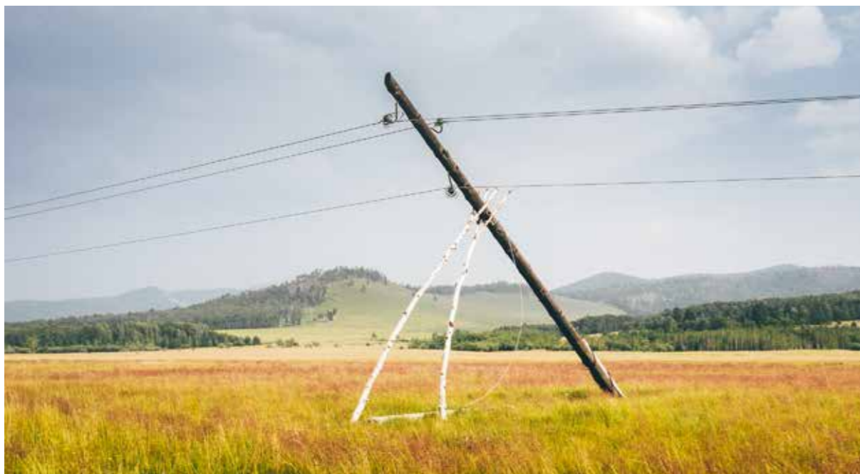
Аварийная опора для опоры ЛЭП
