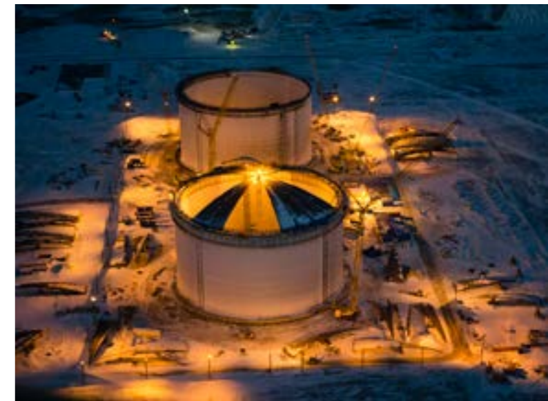
Резервуары для хранения сжиженного газа «Ямал СПГ» Источник: brodyaga.ru
