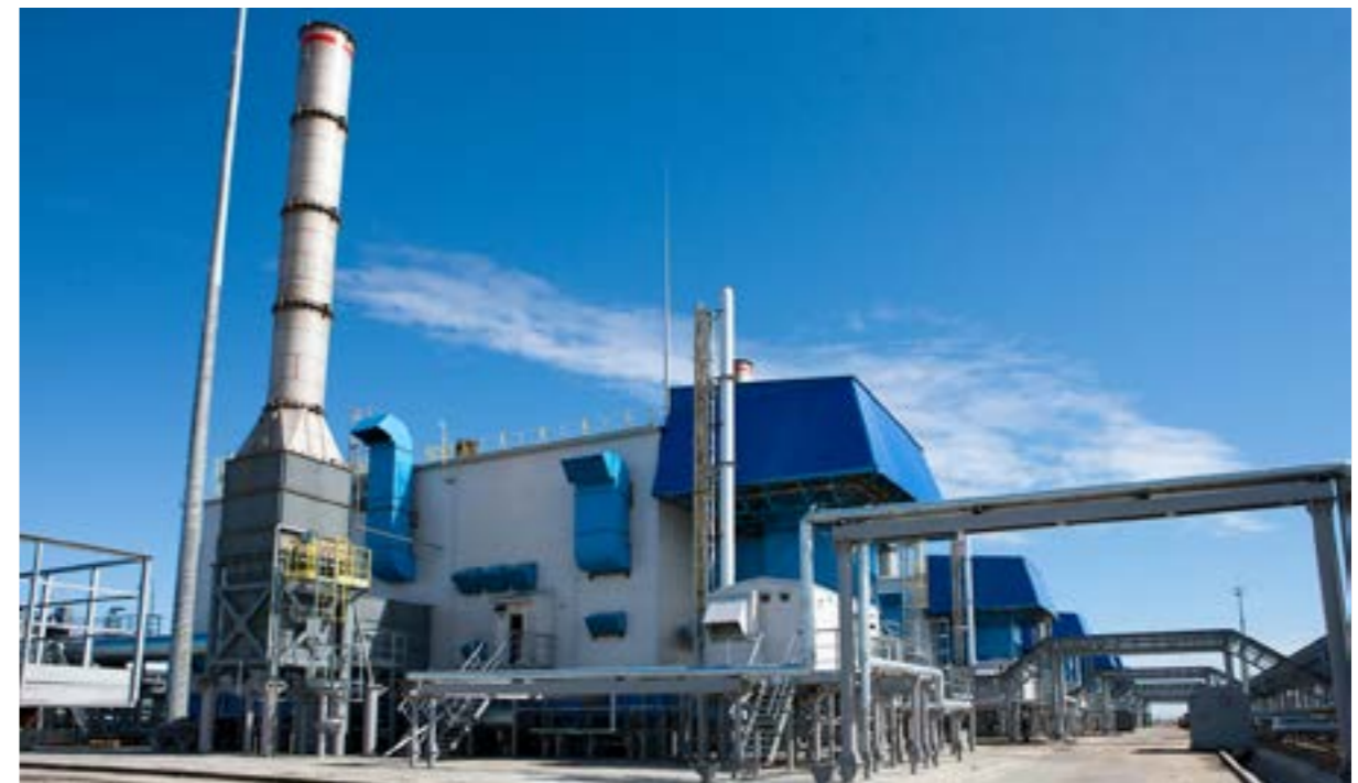
Компрессорная станция Байдарацкая газопровода «Бованенково – Ухта»
