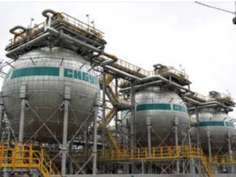
Резервуары парка хранения сырья «ЗапНефтеХим» Источник: «Сибур Холдинг»
