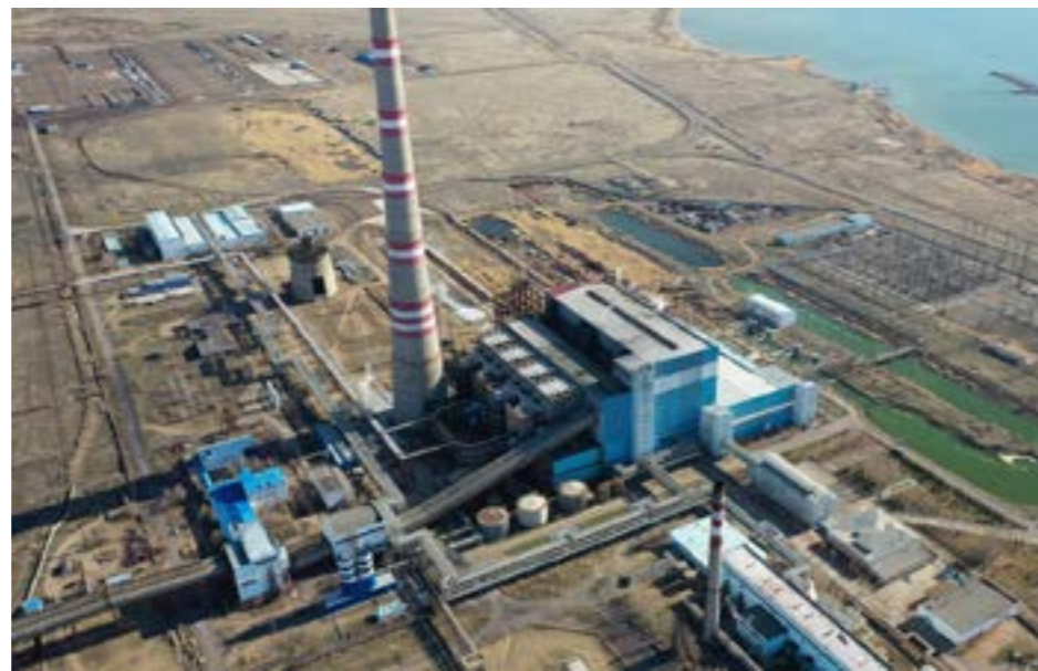
Экибастузская ГРЭС-2 Источник: gres2.kz
