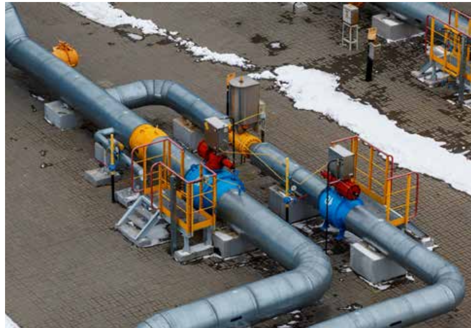
Компрессорная станция «Минская» газопровода «Ямал – Европа» Источник: gazprom.ru
