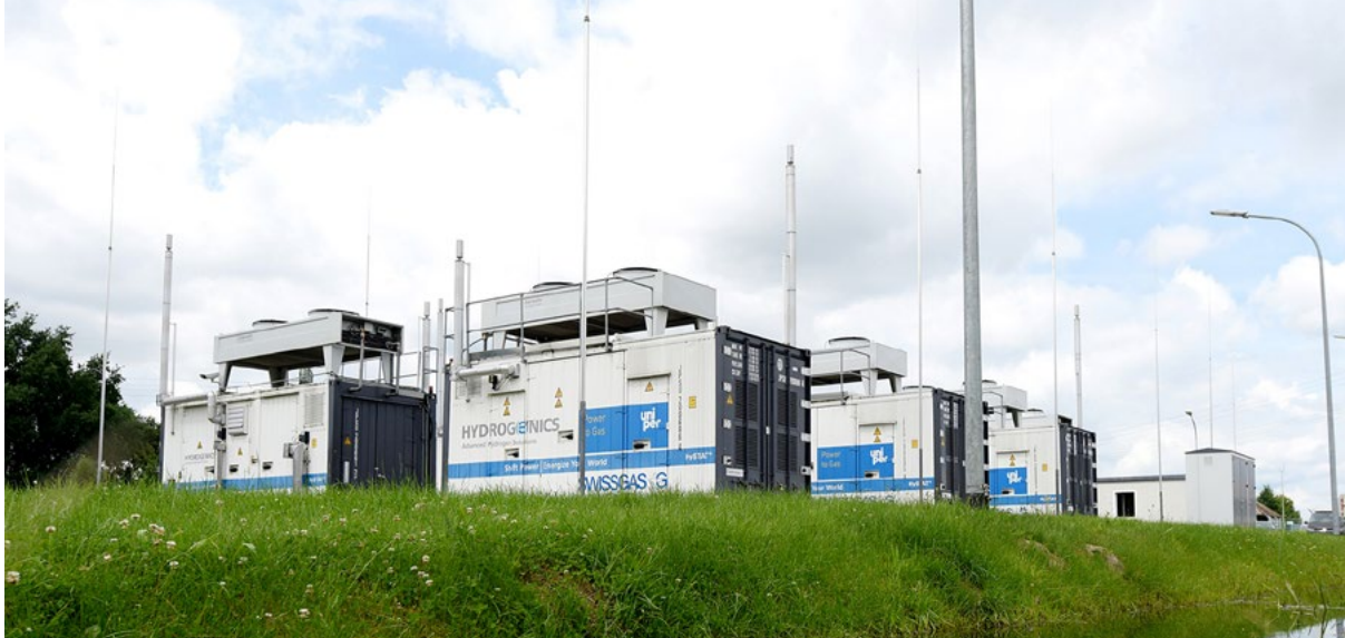
Немецкая установка по производству водорода Uniper
