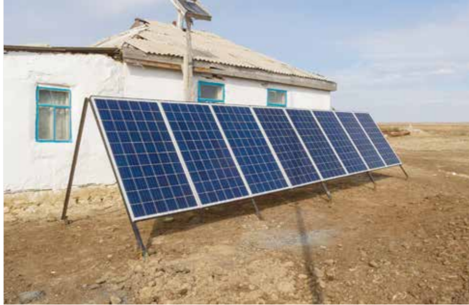
Солнечные панели в деревенском доме Источник: polyset.kz
