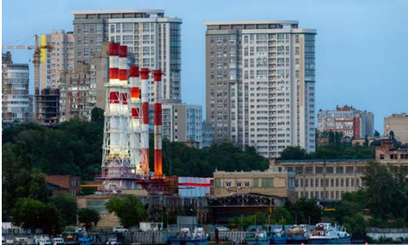
Дымоходы современной котельной
