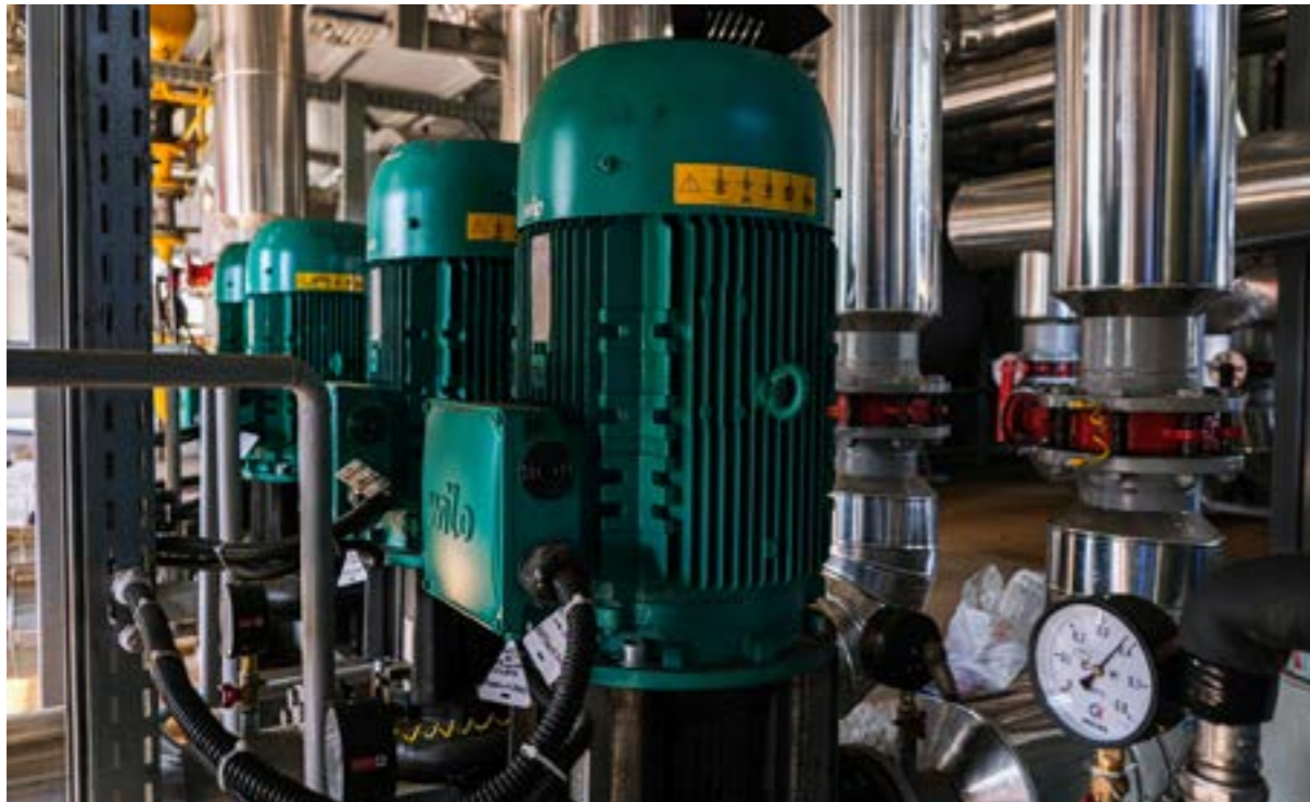
Газовая котельная в поселке Авсюнино
