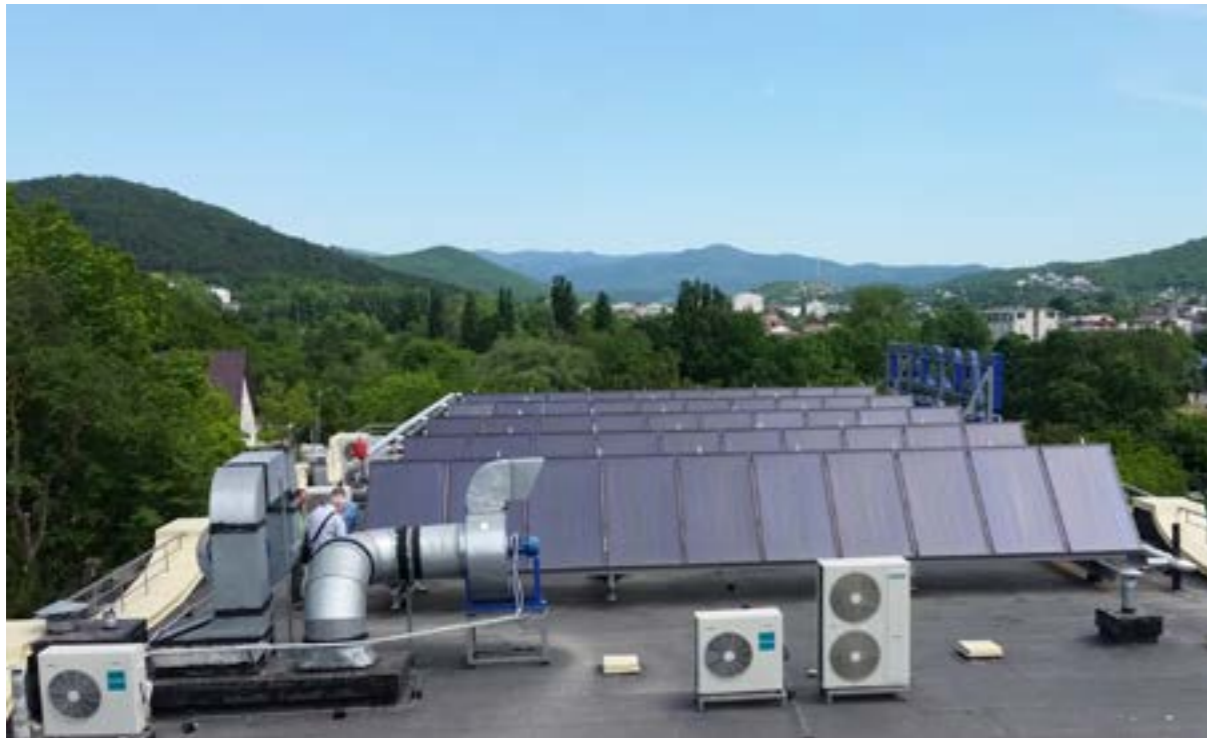
Рис. 5. Гелиоустановка с СК АО «ВПК НПО «Машиностроение» в пос. Архипо-Осиповка Краснодарского края
