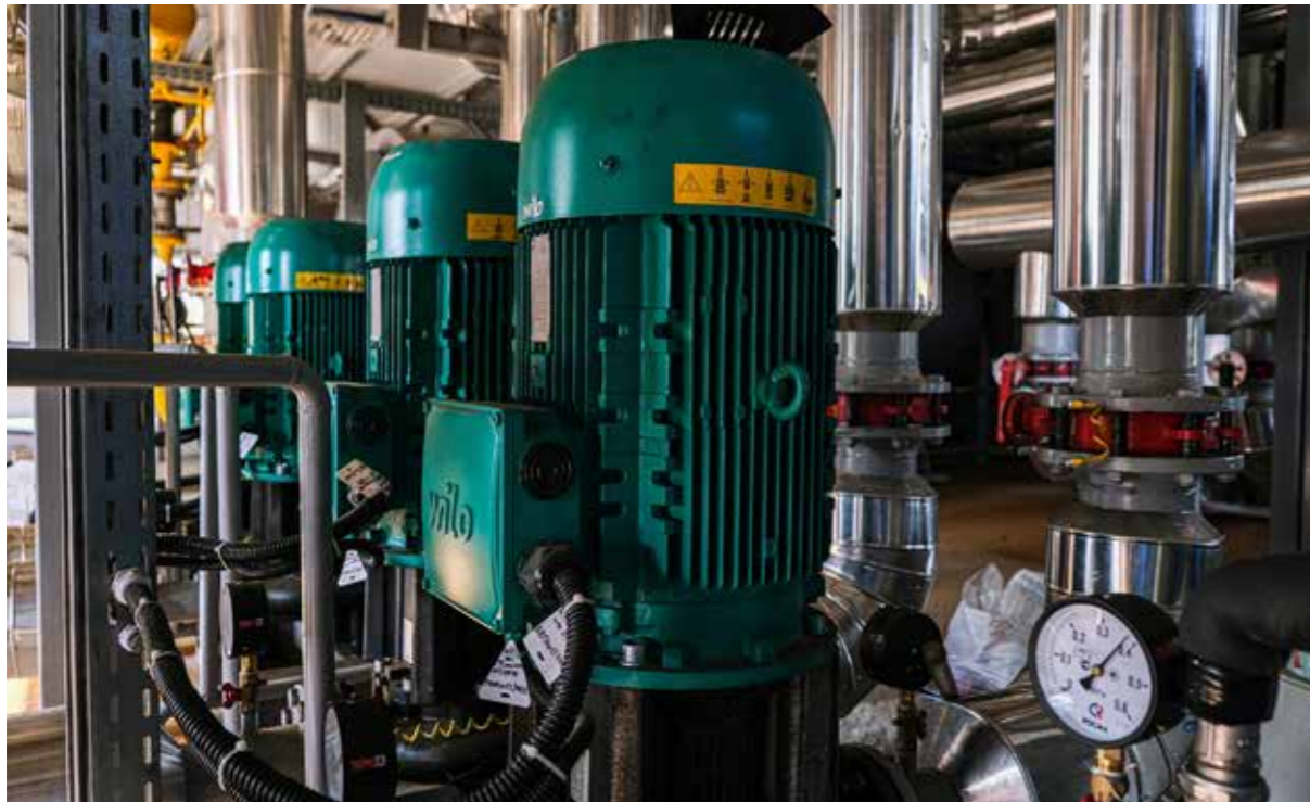
Газовая котельная в поселке Авсюнино
