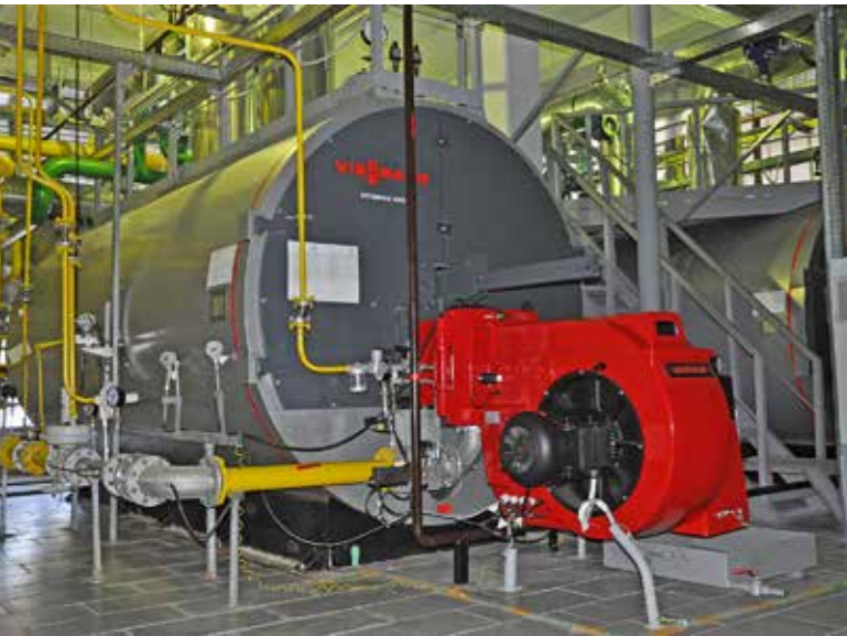
Vitomax 200 LW 6 MBT котел на ТЭЦ Источник: stroiteh-msk.ru
