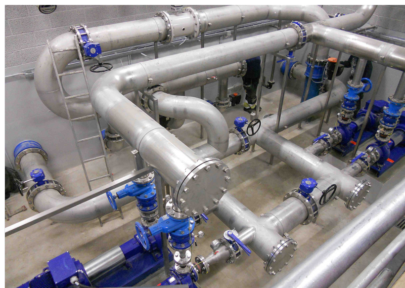
Компрессорная станция Источник: market.yandex.ru
