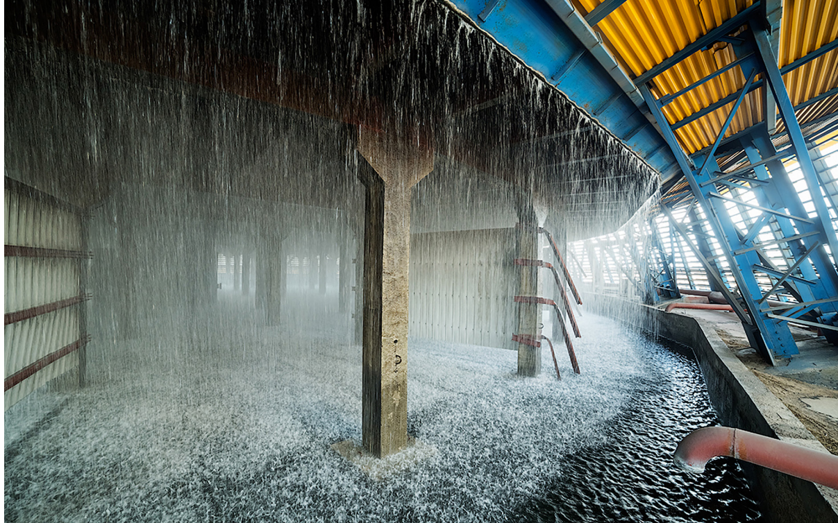
Градирня ТЭЦ с водой
