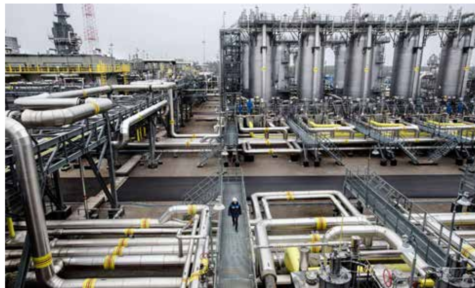
Компрессорная станция Портовая Источник: blackterminal.com
