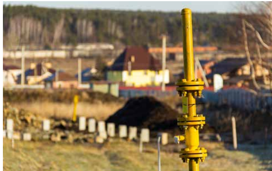
Межпоселковый газопровод Источник: flyural66 / depositphotos.com
